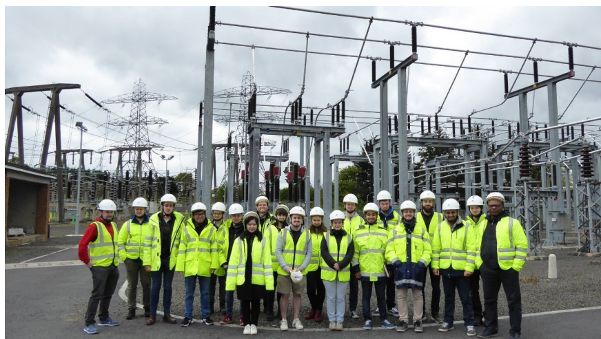
Visite de l'équipe du projet SPIRE 2 et de ses associés de l'université Queen's de Belfast à la sous-station de Castlereagh (275 KV) de NIE Networks le 3 mai 2019.
